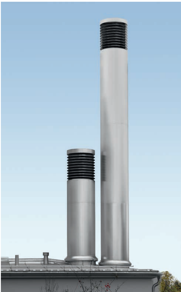
Zu- und Ablufttürme mit Dachdurchführung
