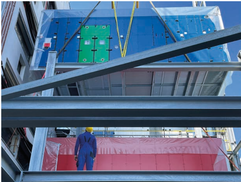
3 m breit, 8 m lang, 3,6 m hoch und 9 Tonnen schwer: Einbringen eines der 32 RLT-Geräte in das neue Main DC Rechenzentrum
