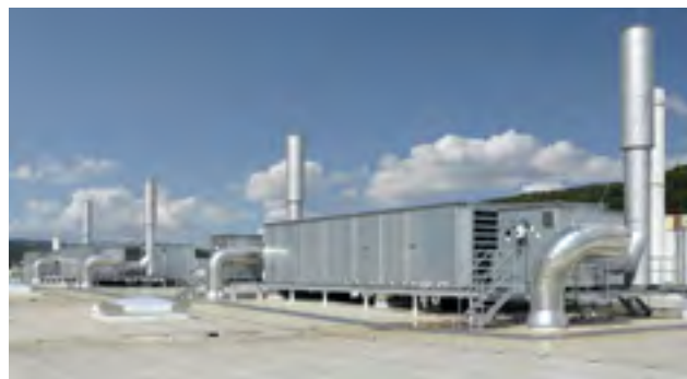
Abluft-Fortlufttürme zur Schweißrauchabsaugung (mit Seilabspannung nach Kundenwunsch)
